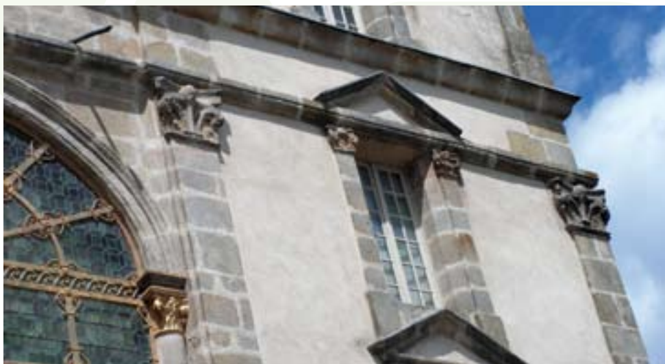
L'encadrement de la Porte Dorée : chaînage des coins, frontons, chapiteaux lourdement sculptés harmonie des pierres grises et de l'enduit blanc
